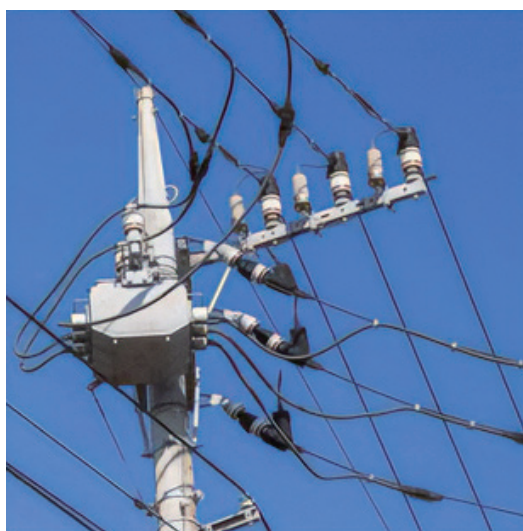
電柱に取り付けられた碍子。 但し、最近の電力線用。
